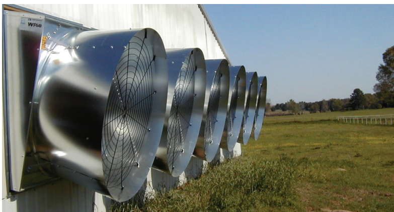
Instalación de ventiladores extractores WF50.
